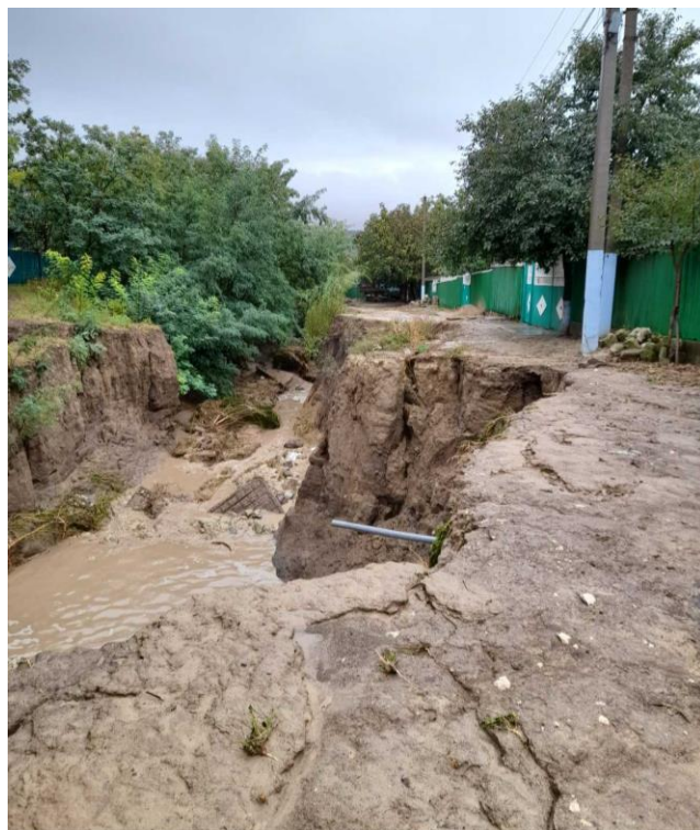
Figura 4. Drum local distrus de apa pluvială
